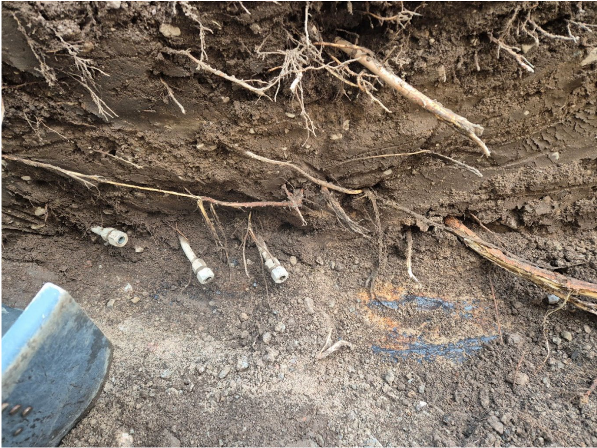
Figur 9: Provtagningspunkt D26. De tre ledningsstumparna samt toppen av oljecisternen.
