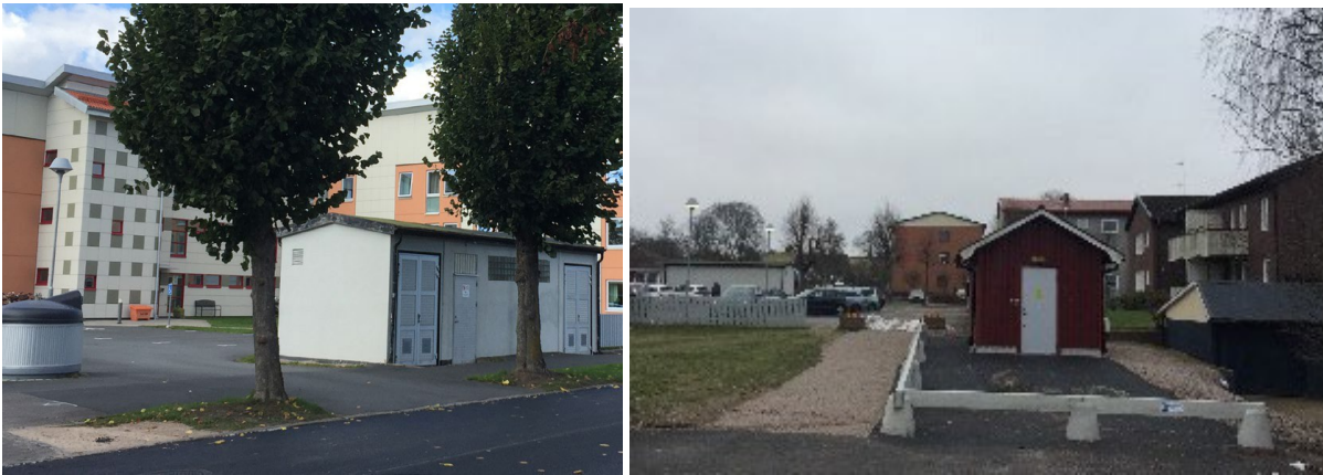
Figur 33: Bilderna visar transformatorstationen inom Falken 10 (sett från Norra Bollgatan) samt tekniskanläggningen inom del av Falken 15, på bild åt höger
